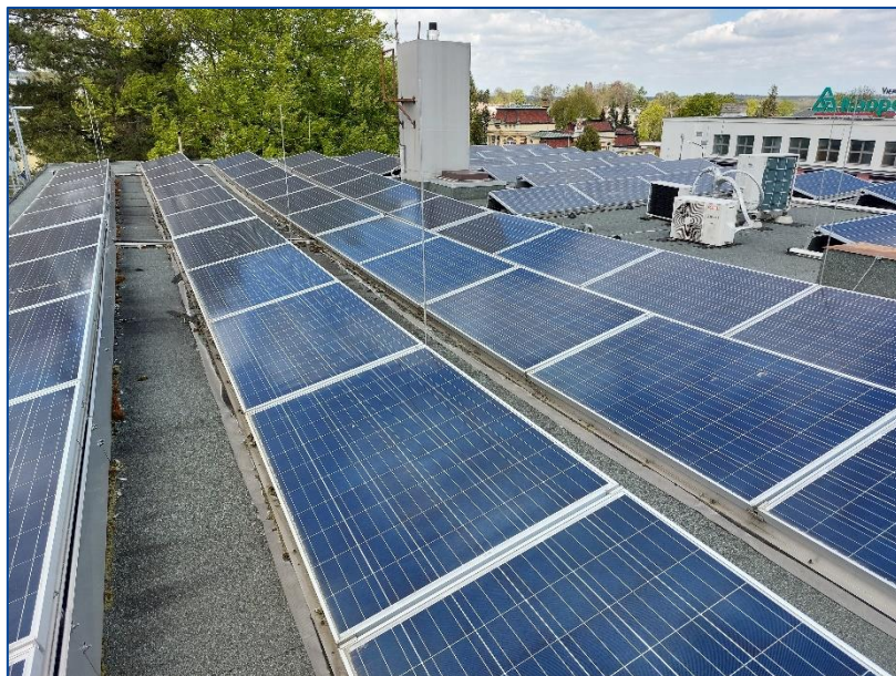
Obrázek 9 - FVE na budově MěÚ Svitavy, T. G. Masaryka 40/25 Zdroj: vlastní zpracování
